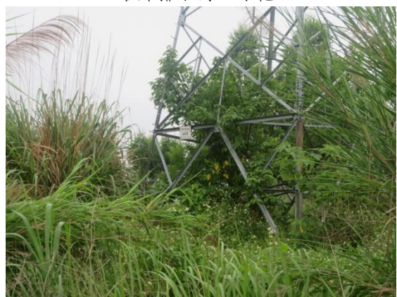
35kV 中南线 4 号
