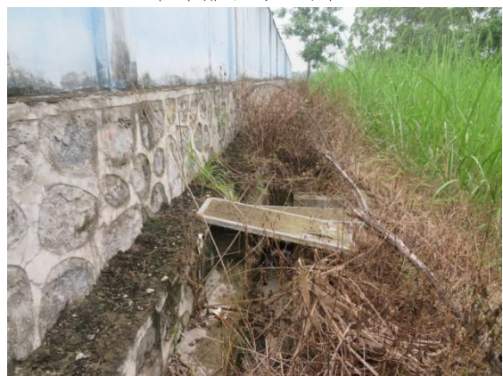
站外排水沟、绿化
