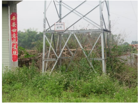
35kV 中南线 7 号
