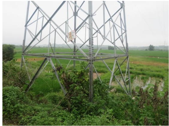
35kV 南桥连线 11 号
