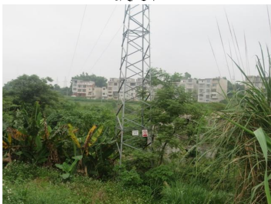
35kV 中南线 2 号
