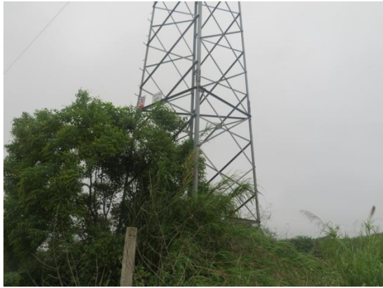
35kV 中南线 5 号
