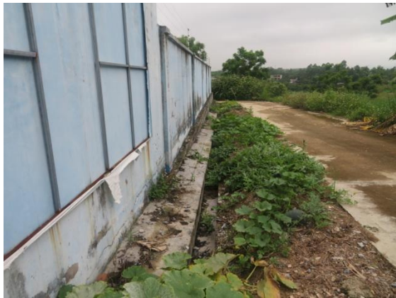
站外排水沟、绿化
