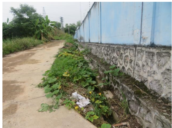
站外排水沟、绿化
