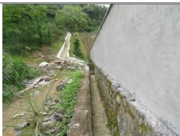
升压站（截）排水沟
