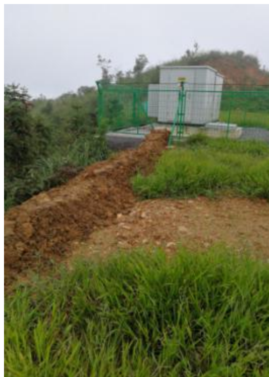
22#风机箱变已设拦水坎坝高于平台
