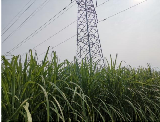
35kV 北雷线 77 号
