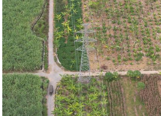
35kV 北雷线 80 号
