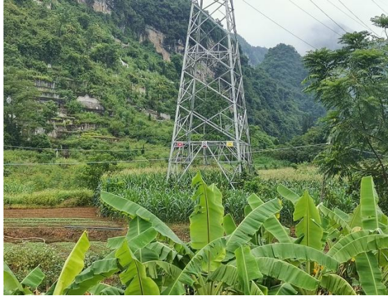
35kV 北雷线 49 号
