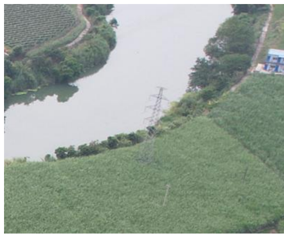
35kV 北雷线 15 号
