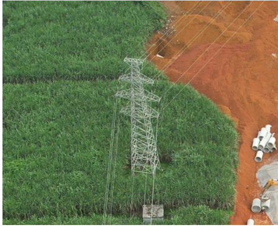
35kV 北雷线 10 号
