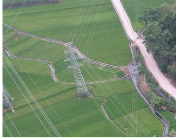
35kV 北雷线 50 号
