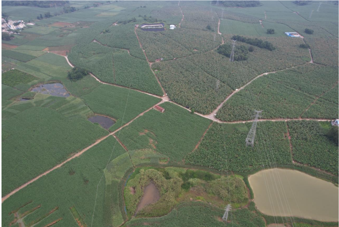
35kV 北雷线（基盖~陇蛮段）
