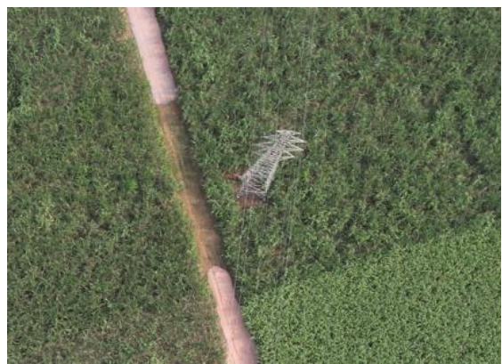
35kV 北雷线 88 号
