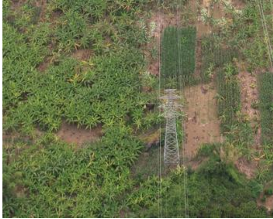
35kV 北雷线 56 号
