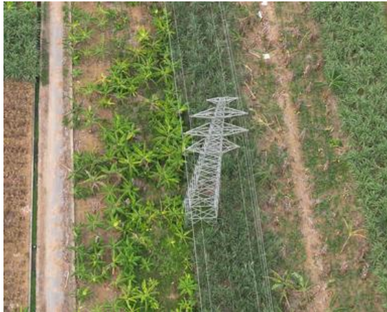
35kV 北雷线 81 号
