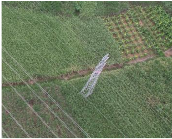
35kV 北雷线 52 号
