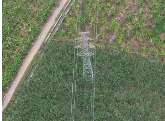
35kV 北雷线 59 号
