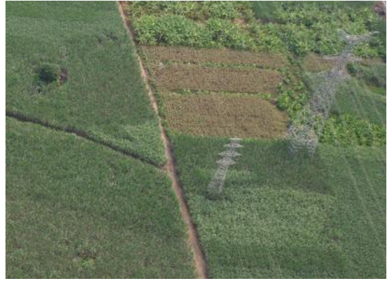
35kV 北雷线 84 号 (小塔)
