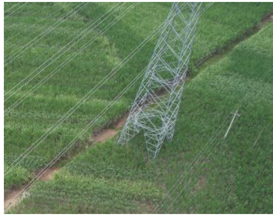
35kV 北雷线 53 号
