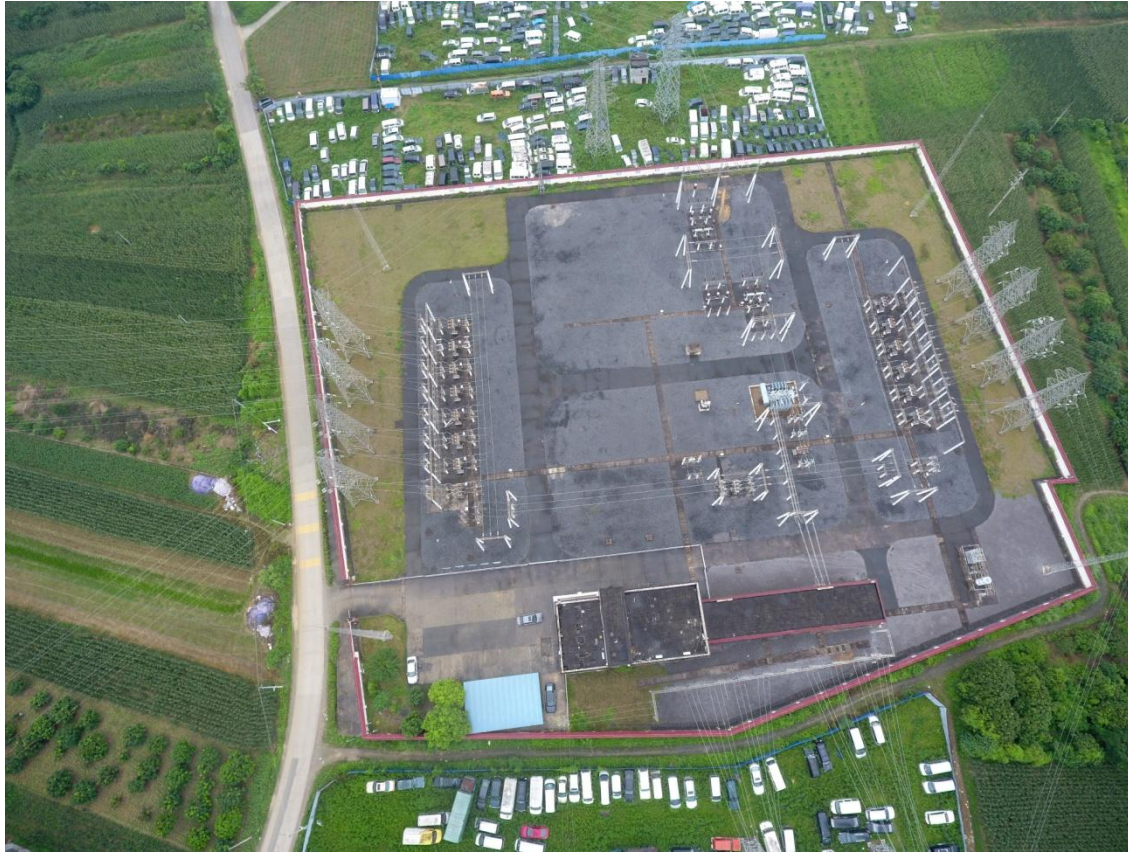
110kV 城北变电站全貌
