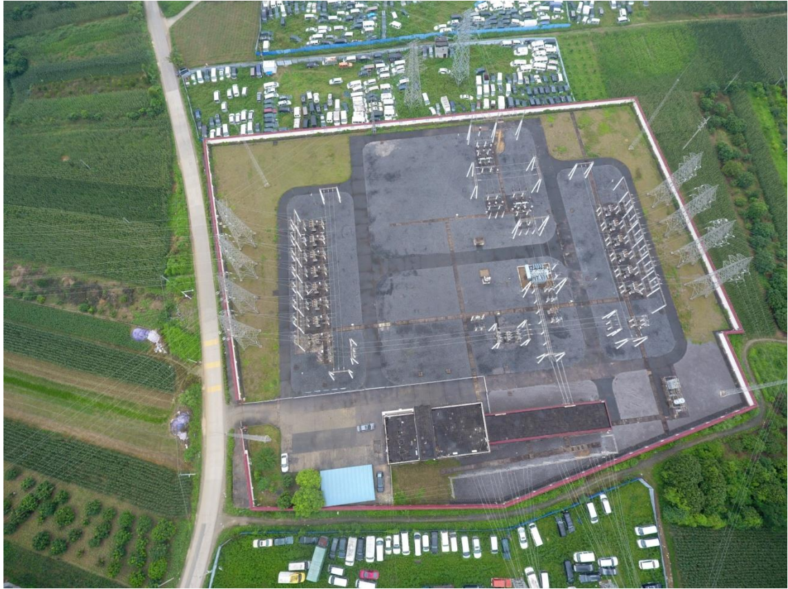
110kV 城北变电站全貌
